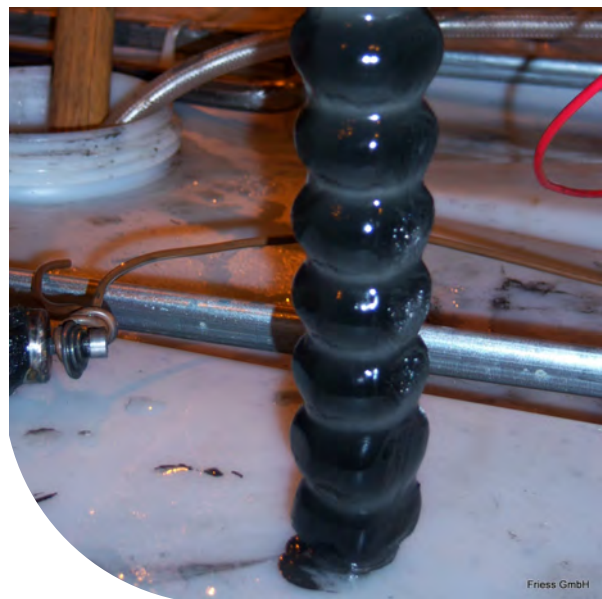
Saletés sur les tiges des filtres magnétiques
