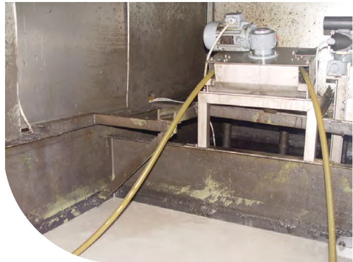
W40 im Betrieb bei Abwasseraufbereitung
