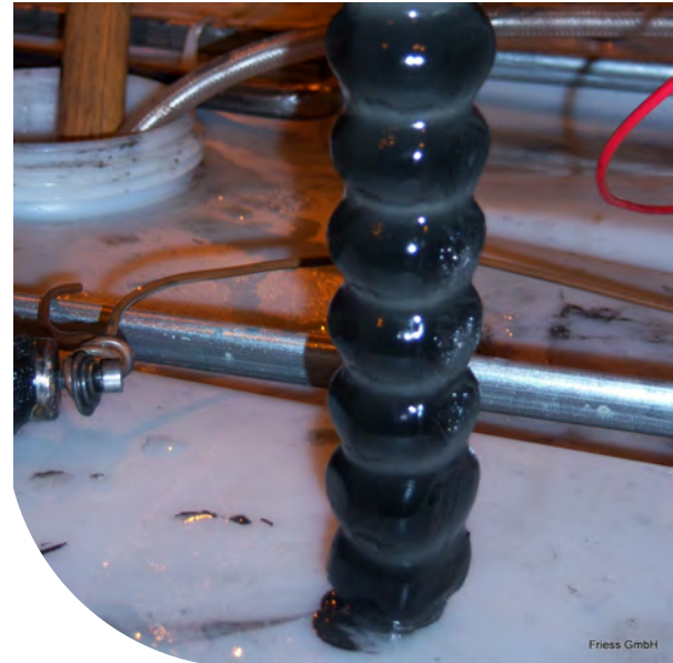
Schmutz auf Magnetfilterstäben
