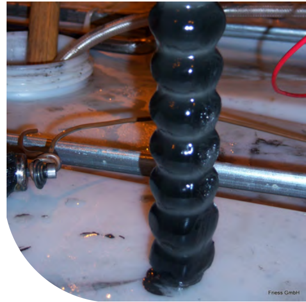
Schmutz auf Magnetfilterstäben
